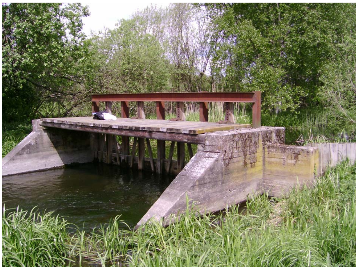
Figur 6. Dämme i Fysingens utflöde till Verkaån. Trots att dämnet läcker bör en faunapassage i form av ett bäckomlöp anläggas förbi detta i syfte att åtgärda nuvarande vandringshinder för fisk och annan vattenfauna. Foto: John Tapper.
